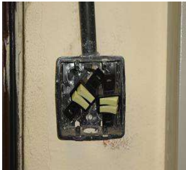
Foto 7 – Interruptor de luz danificado
