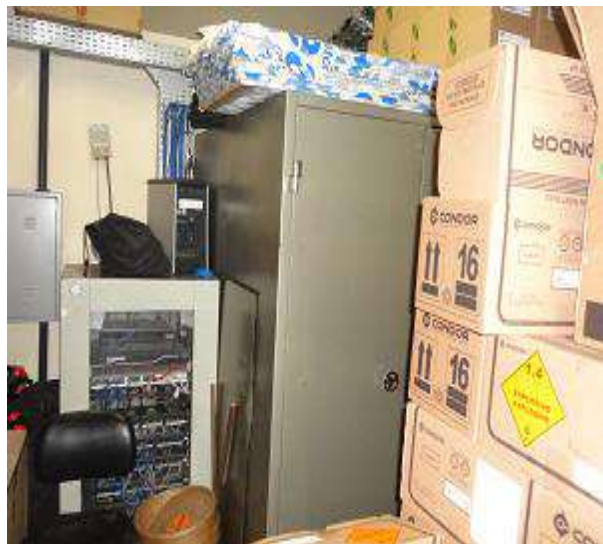
Foto 9 – Equipamentos eletrônicos próximos aos materiais estocados
