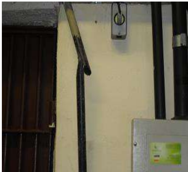
Foto 6 – Tubo de passagem de fiação elétrica danificado
